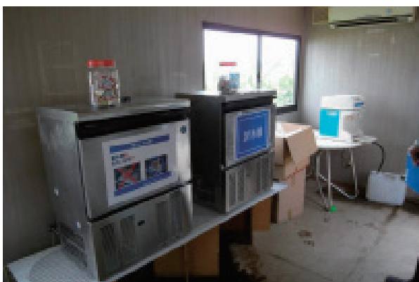
ติดตั้งเครื่องทำน้ำแข็ง, บัวยเค็มญี่ปุ่น (อูเมะโบชิ) ฯลฯ ในสถานที่พักผ่อน
