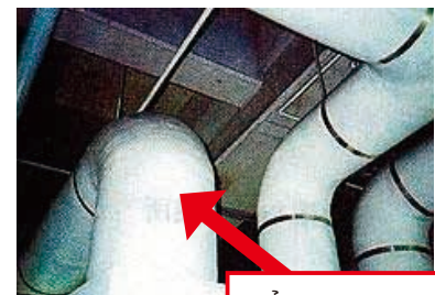
Ống nối hệ thống nước
